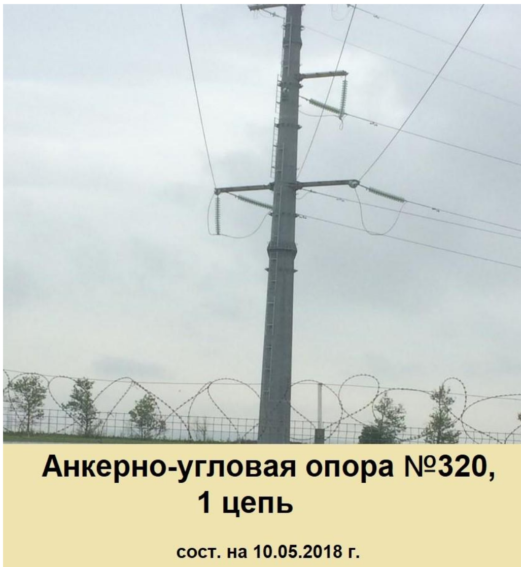
Рисунок 2 – Анкерно-угловая опора ВЛ 220 кВ
